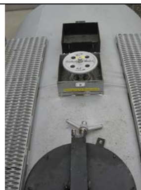
Betätigung des Bodenventils und Domdeckel
